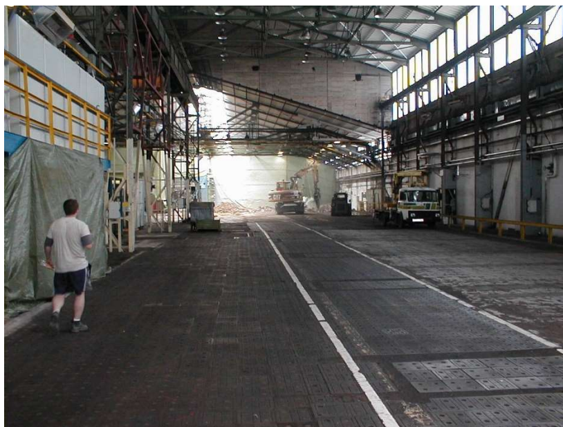
Hala M4 stav před sanací, zdroj: Václav Tima (ŠKODA AUTO a. s.)
