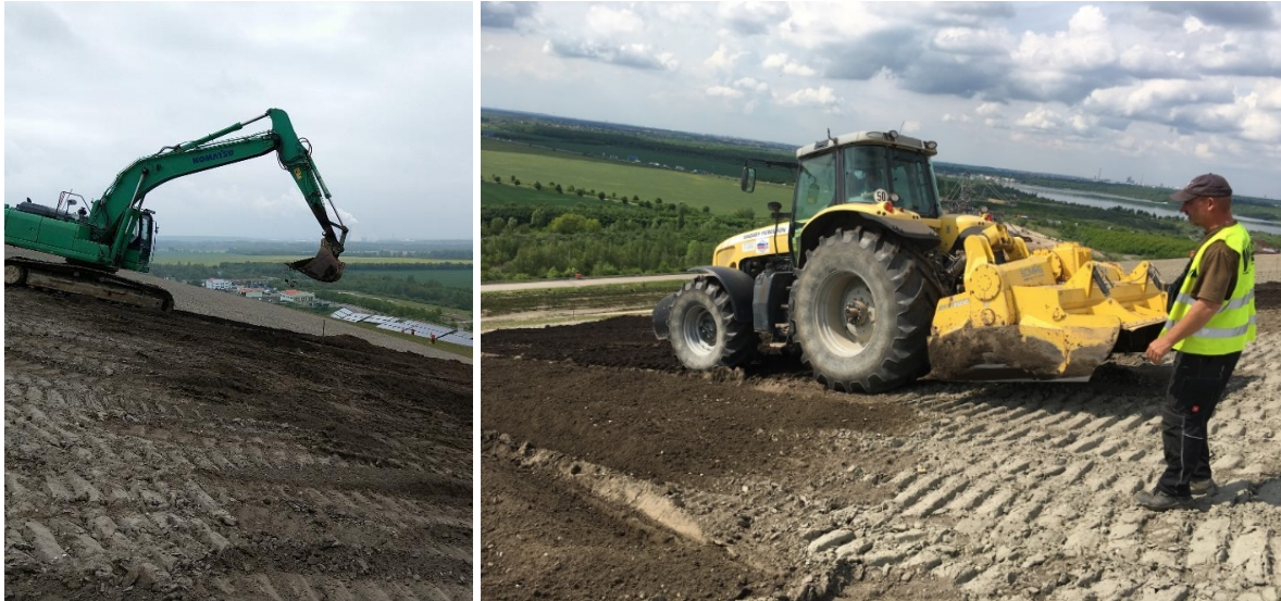
Abbildung 3: Herstellung und Einbau Rekultivierungsschicht auf der Deponie Gröbern links: Auftragen der Kompostschicht und rechts: Homogenisieren und Einbau mit Hilfe einer Bodenfräse.
